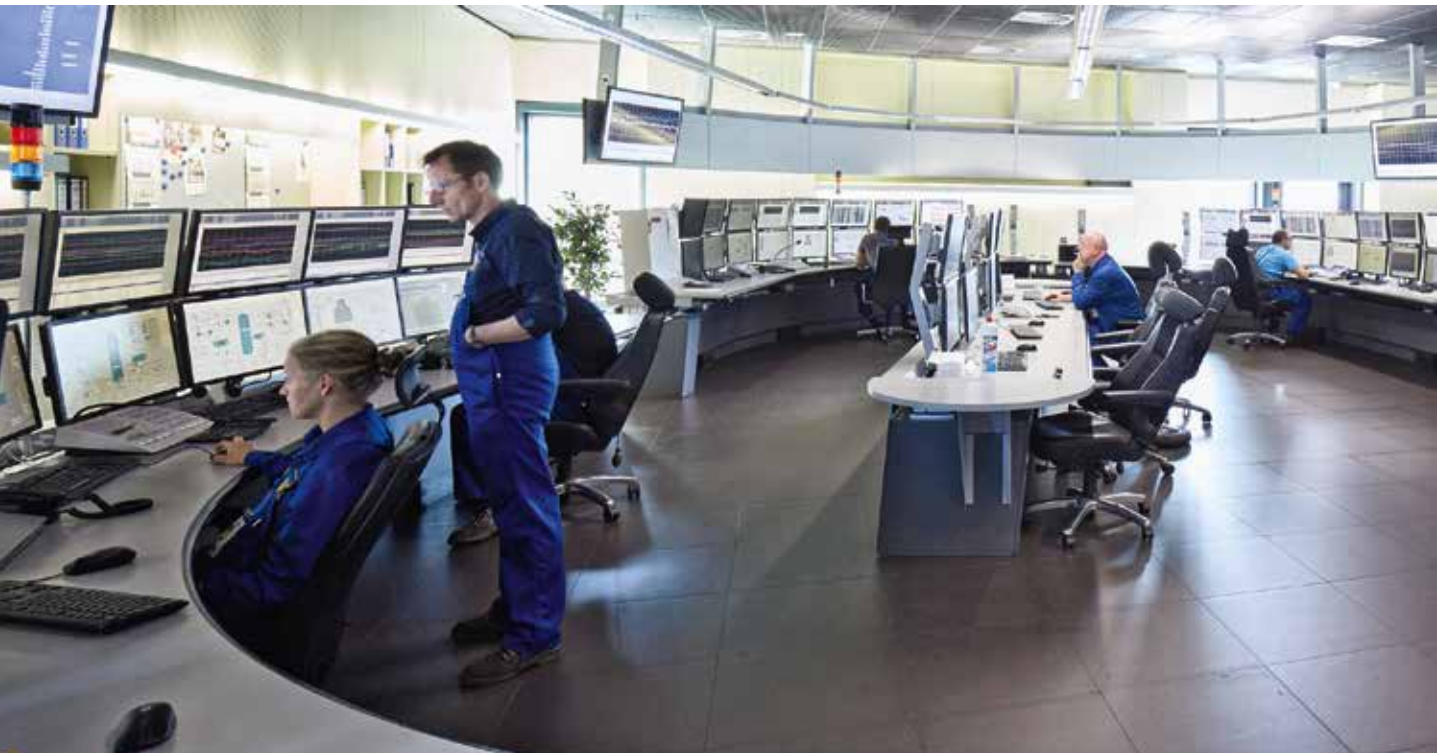
In der Messwarte kann Katrin Wittmoser per Fernsteuerung Änderungen am Kreislauf der Anlage vornehmen.
