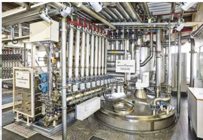
In der Getriebeölmischanlage werden Chargen vollautomatisch hergestellt.
